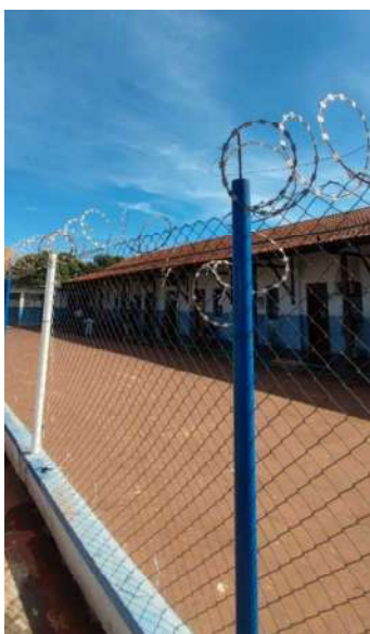
Foto: Concertina quebrada
