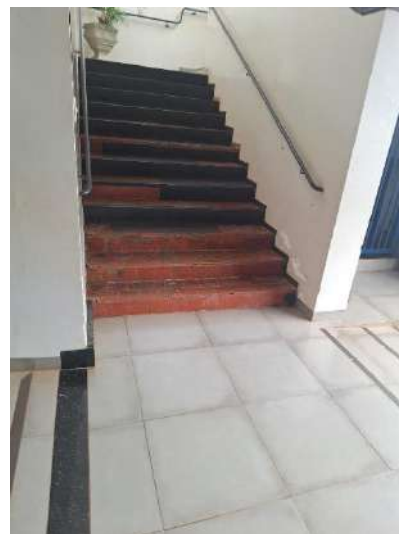
Figura: Antiderrapantes descolados
