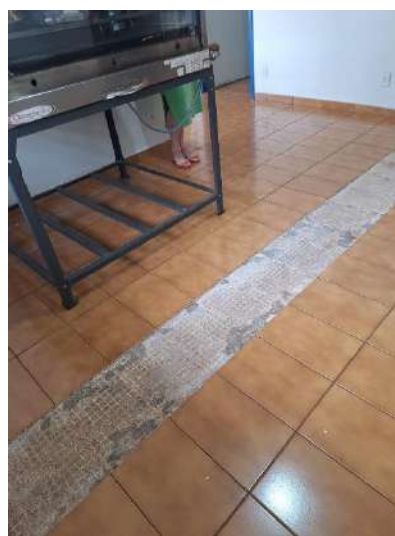
Figura: Pisos quebrados cozinha
