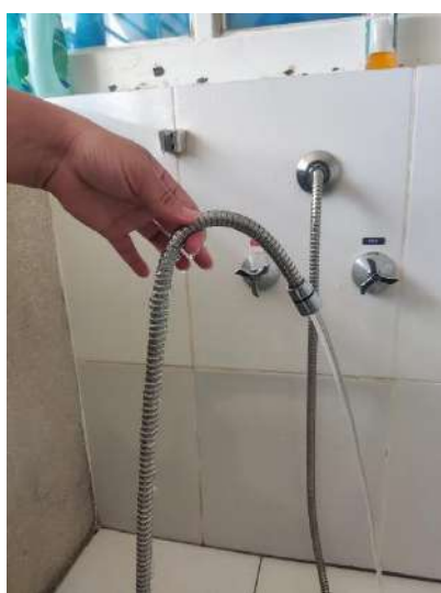
Figura: Vazamento mangueira
